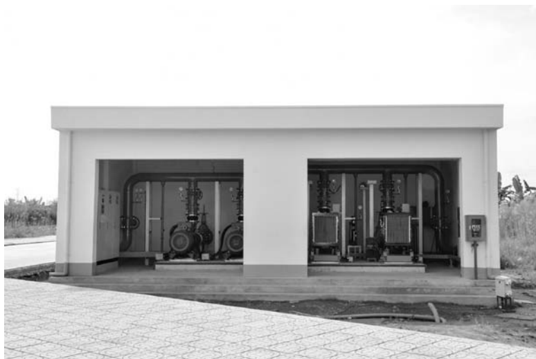
Hệ thống phòng cháy, chữa cháy (bên phải), cấp nước sinh hoạt (bên trái) đã được lắp đặt xong. Ảnh: HOÀNG LAN
