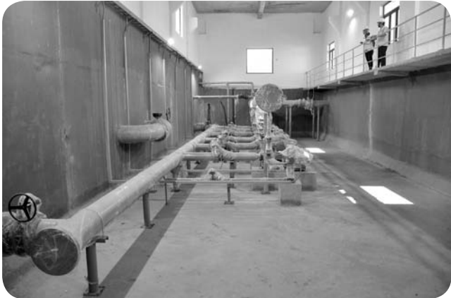
Hệ thống phòng cháy, chữa cháy tại KCN Trần Đề đã lắp đặt xong. Ảnh: HOÀNG LAN
