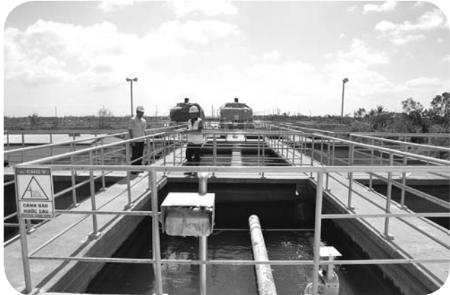
Hệ thống xử lý và cấp nước sạch với công suất cấp nước đạt 5.800m 3 /ngày đêm, đảm bảo cung cấp nước cho các nhà đầu tư thứ cấp. Ảnh: HOÀNG LAN
