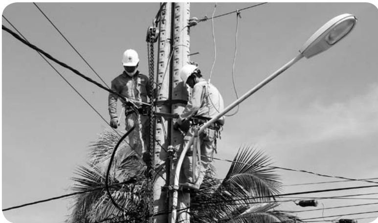
Công ty Điện lực Sóc Trăng đảm bảo cung cấp điện an toàn, liên tục và ổn định trong dịp Lễ 30/4, 1/5. Ảnh: PCST
